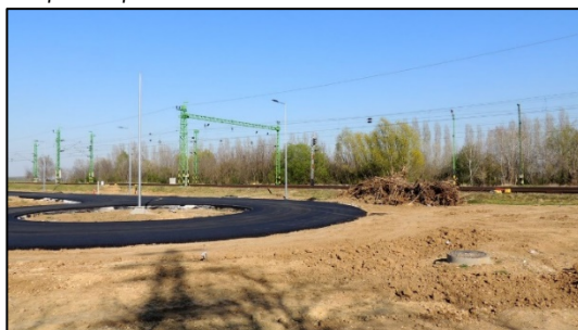
A fejlesztési területet K felől határoló, új építésű út jellemző állapotképe, mögötte a Sopron–Szombathely villamosított vasútvonallal
