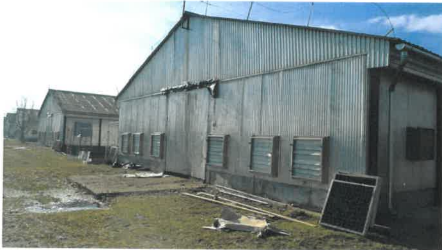
Az 1. számú istálló ventilátorai
